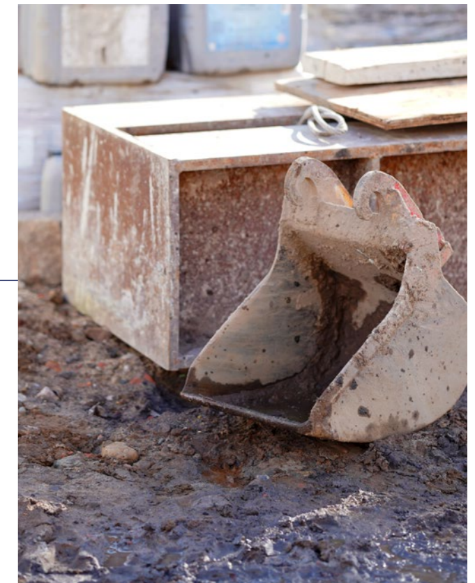
Mit dem Aufbau unseres Bodenmanagements wollen wir Bodenaushub von Leitungsbaustellen aufbereiten und bei Abschluss der Baumaßnahmen wieder einbringen.
