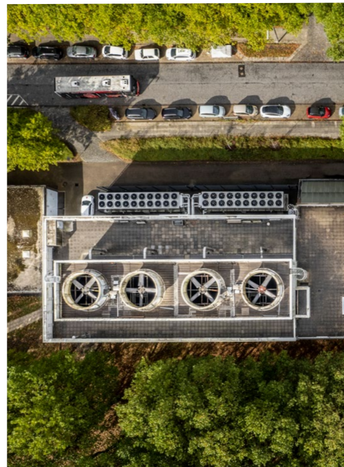
Unser Fernkältewerk kühlt die Bürogebäude und Rechenzentren der CityNord über unser zwölf Kilometer langes Fernkältenetz.
