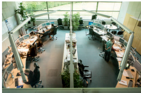
24/7 unter Strom: Von der Netzführung aus überwachen wir rund um die Uhr die Versorgung des Hamburger Stromnetzes.
